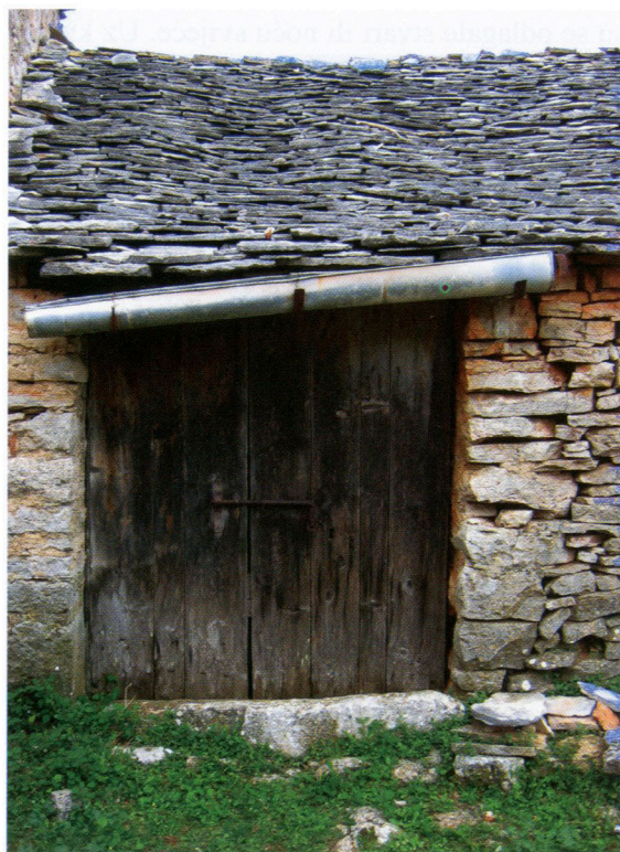
Zaštita ulaza od kiše limenim olukom. Umjesto upotrebe oluka, bolje je popraviti zaštitu istakom od kamenih ploča.
